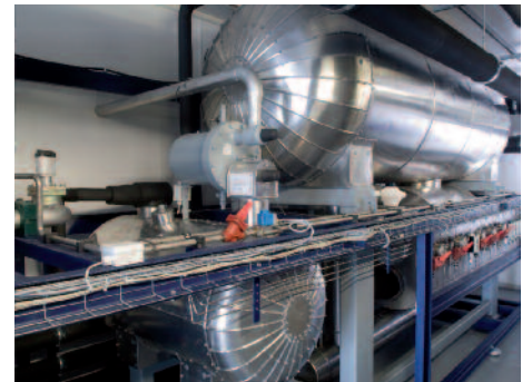
NH 3 /CO 2 -Maschinen-Anlage innerhalb des Containers
