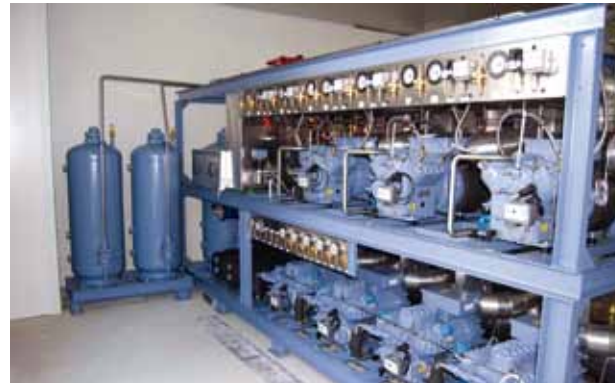
Die Kaskade-Sole-Kälteanlage mit Regelungstechnik für die Einspeisung der Gefriertrocknungsanlagen.
